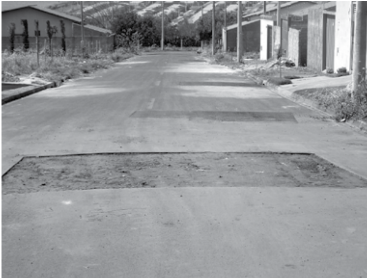
Ruas do bairro estão tomadas por recortes de estouros de encanamentos
